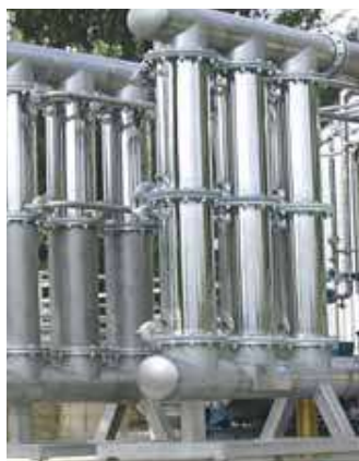
Impianto a membrane ceramiche
